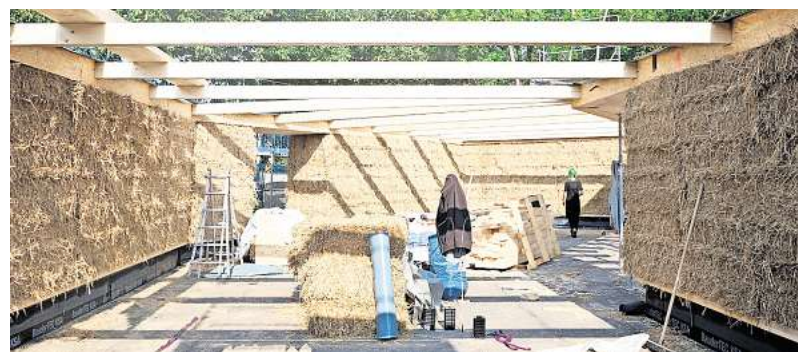
Keine zwei Wochen hat es gedauert, bis im Sommer der Rohbau des Stroh-DGHs in Erbsen stand. Inzwischen hat das Gebäude ein Dach.
